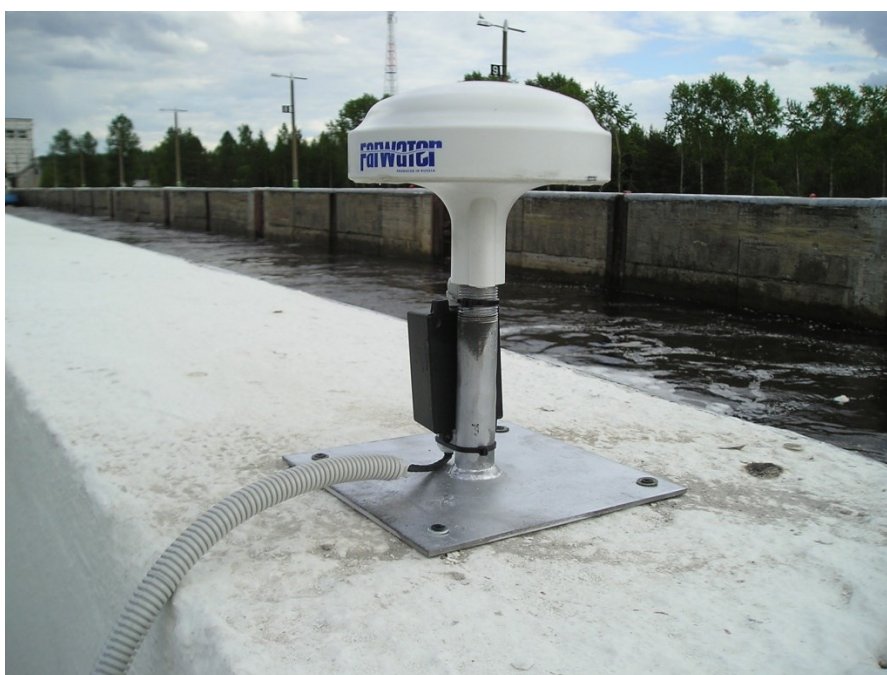
Рисунок 5 – Контроль камеры судоходного шлюза
